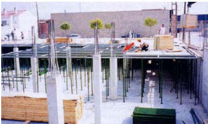
Proceso de colocación de los tableros en los encofrados, con un evidente riesgo de caída a distinto nivel
