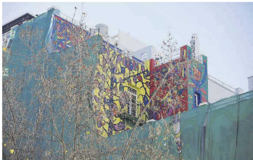
El mural ha sido ocultado por telas de obra situadas delante de los andamios.
