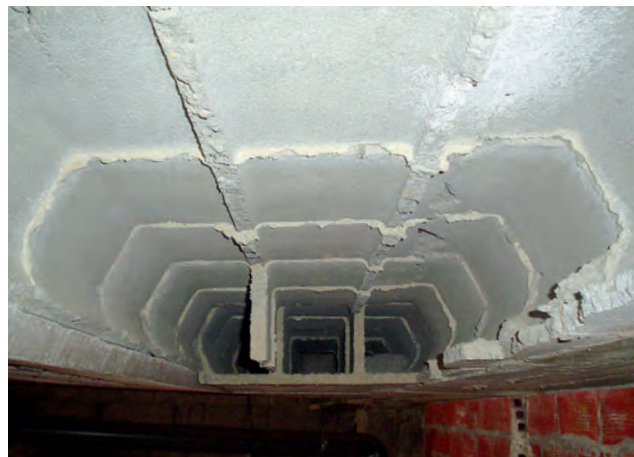
Fig. 13 (izquierda): rotura y desprendimiento de bovedillas cerámicas por expansión de humedad.
