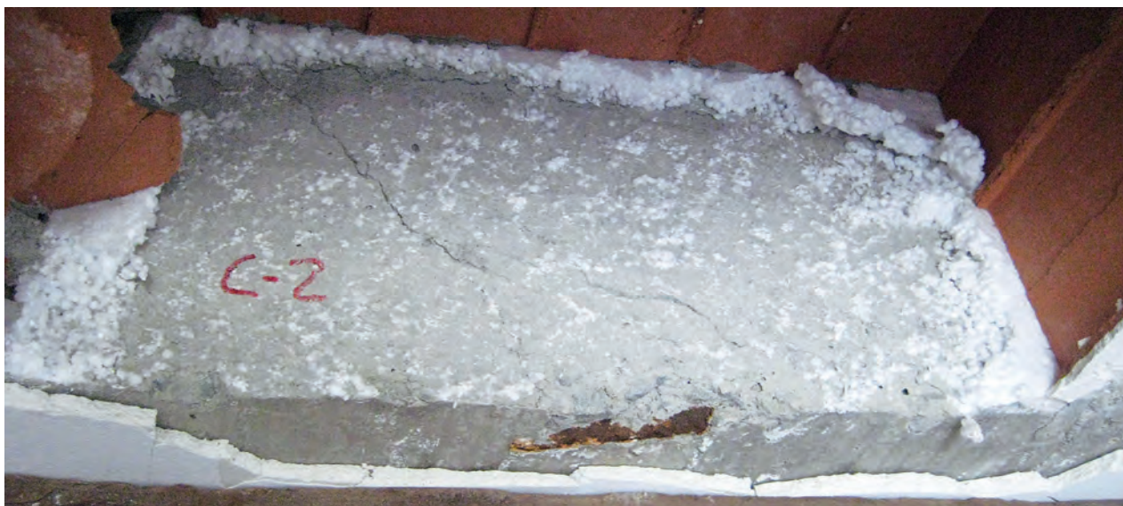
Fig. 19: fisuración en viga por esfuerzo cortante.
