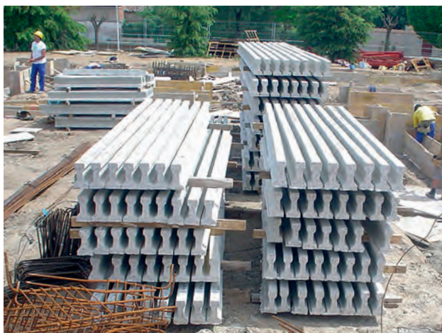
Fig. 4 (izquierda): acopio de viguetas sin identificación.
