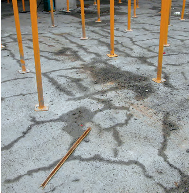
Fig. 15 (izquierda): fisuración por retracción hidráulica.
