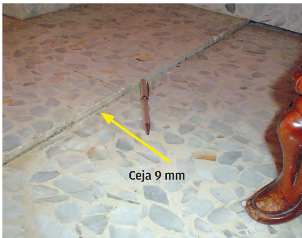
Fig. 11 (izquierda): lesiones en solado por deformaciones diferenciales o excesivas de forjados.
