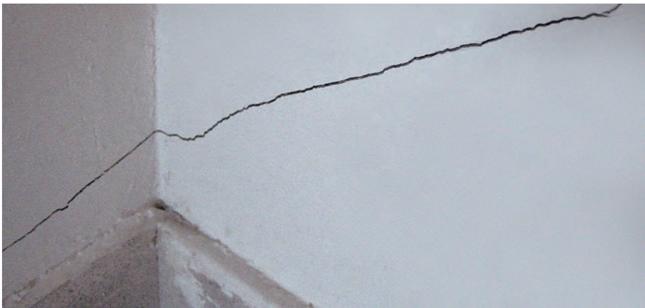
Fig. 9: lesiones en tabiquería por deformaciones excesivas de forjados.
