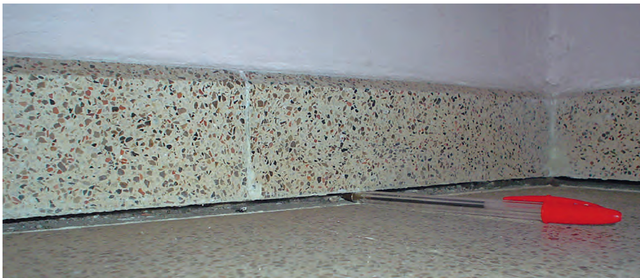
Fig. 10: separación tabique- solado por deformaciones diferenciales o excesivas de forjado.
