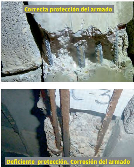
Fig. 32 y 33: comportamiento de los recubrimientos del armado de viguetas, según espesores y/o calidad del hormigón.
