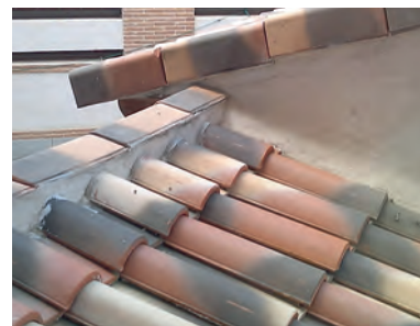
Fig. 4: fisura característica en la parte superior del borde lateral de una cubierta inclinada (bajo pieza especial de remate).
