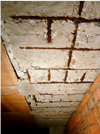
Figura 6: corrosión del armado de una viga. Ausencia de recubrimiento.
