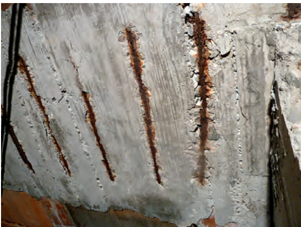
Figura 3: deficiente recubrimiento. Corrosión de la armadura.
