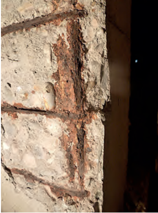
Figura 5: corrosión de las barras corrugadas de un pilar. Condiciones ambientales. Carbonatación.
