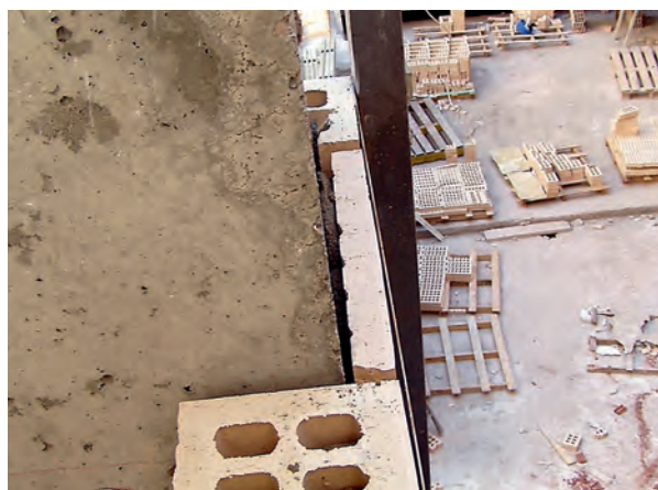
Figura 1: espesor insuficiente del emparchado de un pilar.
