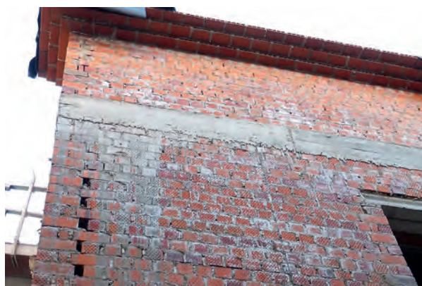
Figura 2: deficiente ejecución de fachada de 1 pie de espesor.
