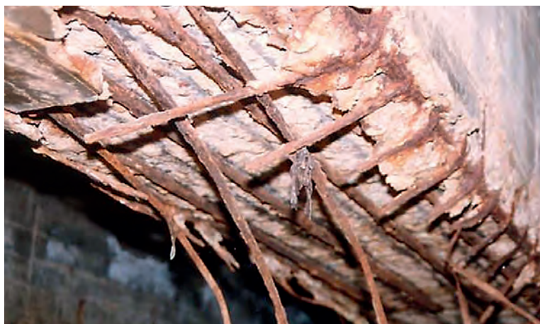
Figura 10: corrosión en el armado de viga por ataque de cloruros. Zona marítima.
