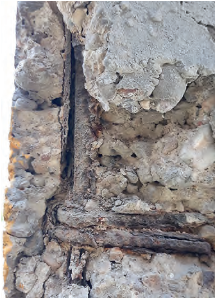
Figura 7: corrosión de las armaduras y desprendimiento del hormigón de un pilar.
